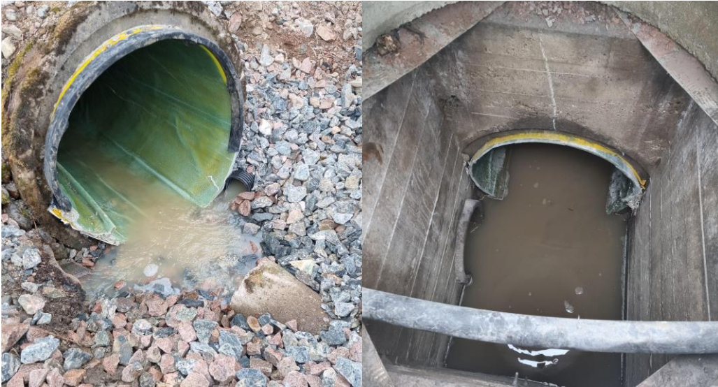
Figur 13. Trumma 1, bild till vänster visar inlopp och bild till höger visar utlopp på östra sidan av järnvägen. Vattnet antas rinna vidare i den mindre ledningen mot diket.
