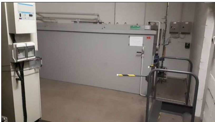
Figur 7, dieseltank och del av reservkraftaggregat (till vänster i bild).
