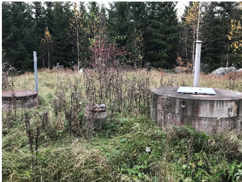
Foto: Västerås stad. Svavelvätebrunnar.
